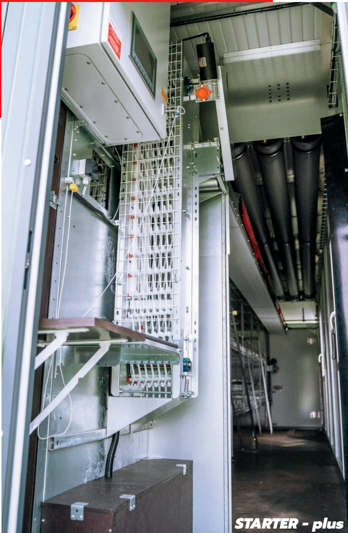
STARTER - plus : Hygieneschleuse mit einer Zugangstüren zum Scharraum
