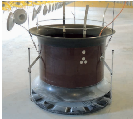
Zuluftelement zum Reinigen am Boden
