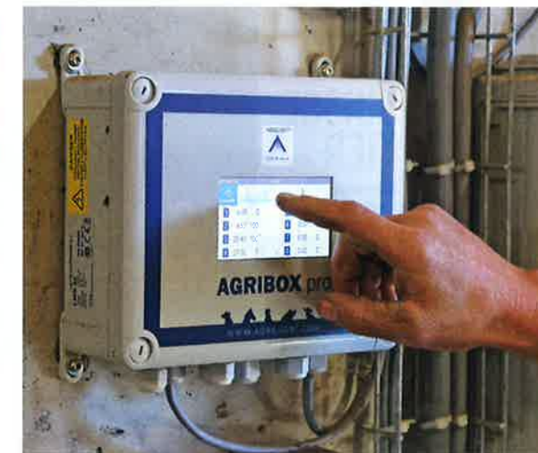
Am Steuergerät wird das Lichtprogramm eingestellt.
