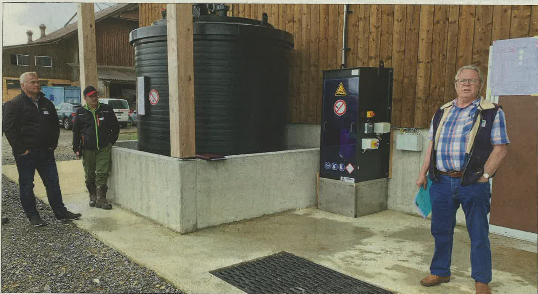
Edi Arnold erklärt die Funktion der Gülleansäuerung. Hinten der Säuretank, rechts die Pumpe mit der gesamten Steuerung. Von hier wird die Schwefelsäure in die Gülle eingegeben.
